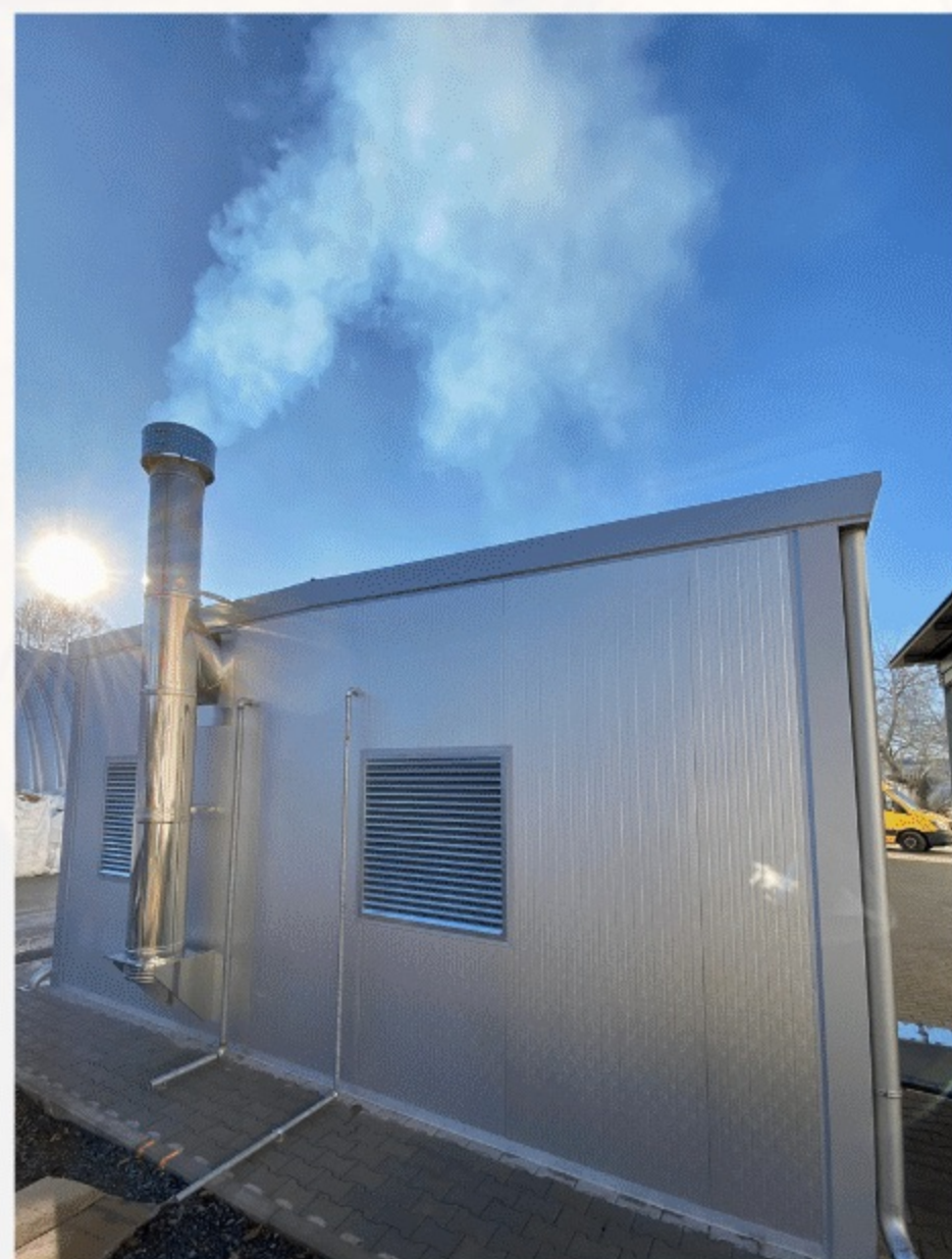
Centrali termiche prefabbricate su container
